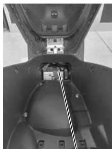
Vano ispezione batteria
